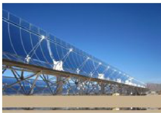
Sistema de demostración que presenta 16579 pies cuadrados de 3M Solar Mirror Film 1100 y los Gossamer Space Frames para montar los espejos de menor peso de las instalaciones de Sunray Energy en Daggett, California, hogar del recinto de concentradores solares parabólicos de más antiguo funcionamiento en los Estados Unidos.
